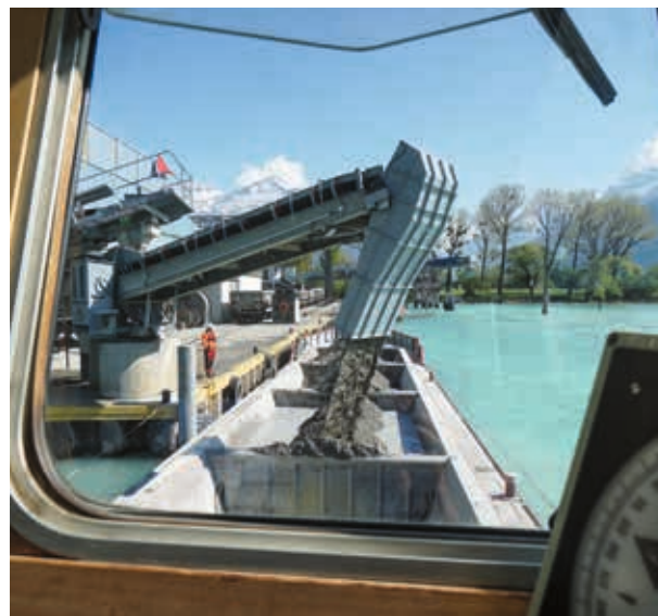
Das Material für die Testphase von April bis Juni 2023 stammte aus dem ersten Stück des Gotthard-Strassentunnels und seinem Zugangsstollen. Das waren rund 100000 t Granit und Gneis.
